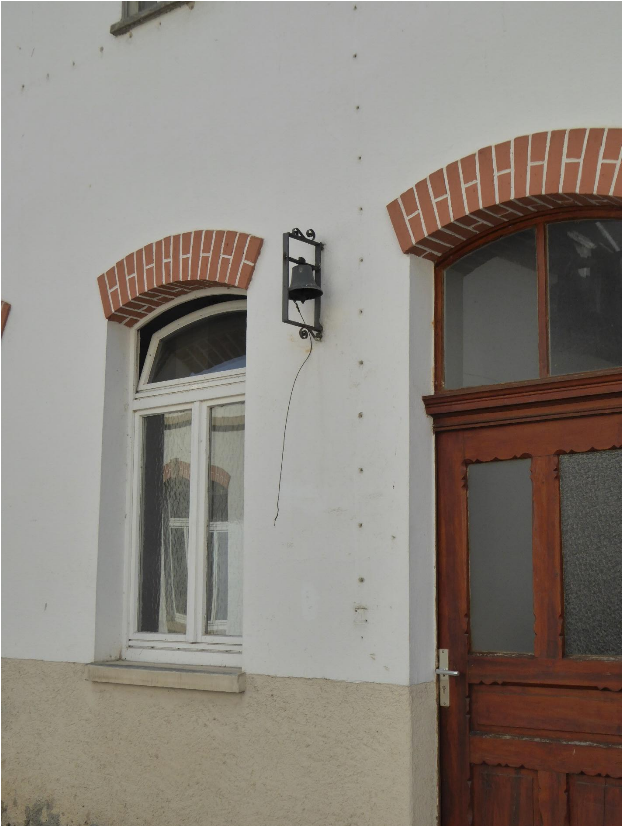
Abb. 3 Der Blick von der anderen Seite, leider ohne die Sicht auf weitere Fenster und Türen
